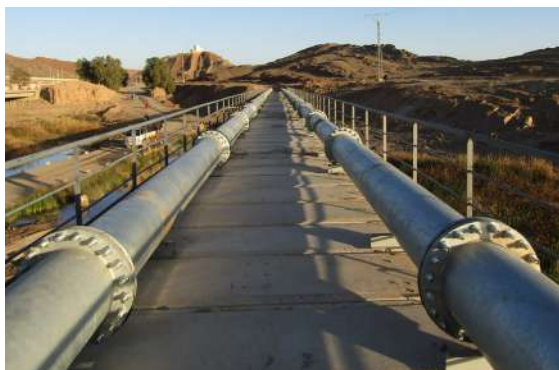
Diamètre : 600 mm Longueur : 70 Km Matériaux : AGC / FD / PRV / PVC
