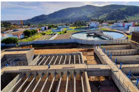
Type : Conventionnel avec filtration à sable Débit traité : 330 l/s Eau brute : Prise sur barrage
