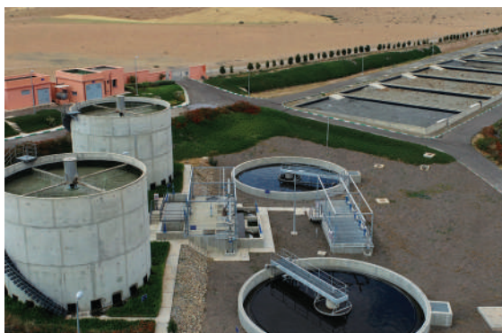
Station d'épuration de la ville de IMINTANOUTE
