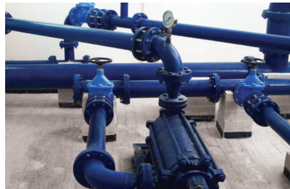
Type : Pompage sur forage et station de reprise Capacité : 100 Kw
