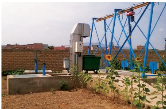
Type : Relevage des eaux usées Capacité : 74 Kw
