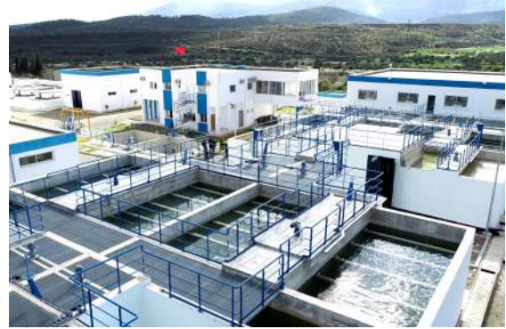
Type : Conventionnel avec filtration à sable Débit traité : 160 l/s Eau brute : Prise sur barrage
