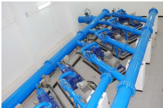
Type : Pompage eaux brutes et eaux traitées Capacité : 1 372 Kw
