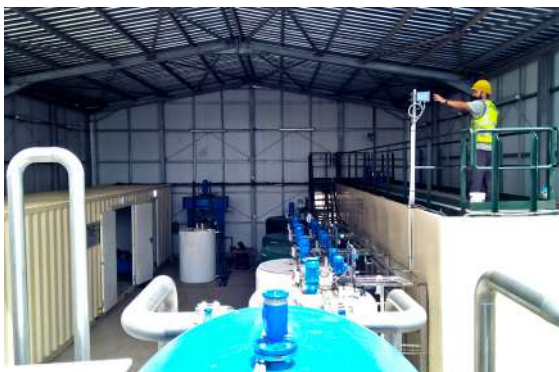
Type : Station de traitement d'eau potable avec filtration à sable Débit traité : 100 m 3 /h Eau brute : Prise sur fleuve du Sénégal
