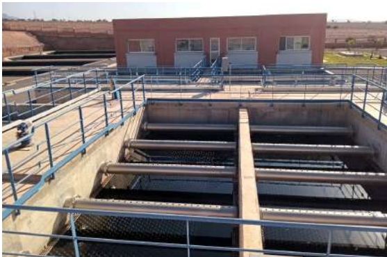
Type : Conventionnel avec filtration à sable Débit traité : 145 l/s Eau brute : Prise sur barrage
